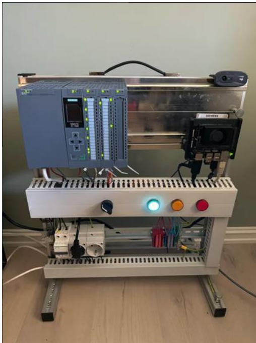
Figur 26 - Automasjonstavle tilstand «fôring pågår»
