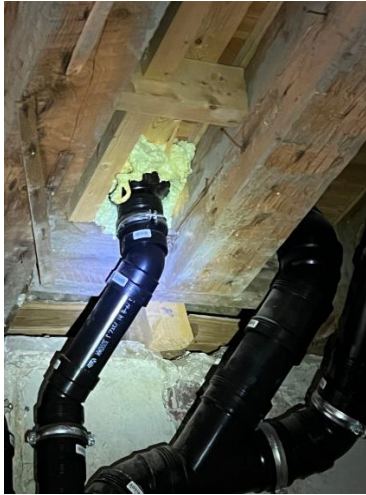
Rør i PE
