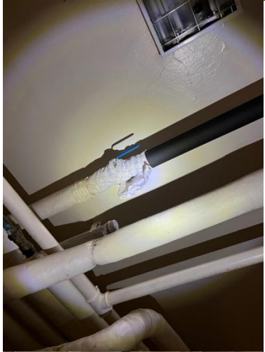
Mindre lekkasje ved stoppekran
