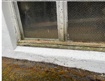
Fuktighet rundt vindu
