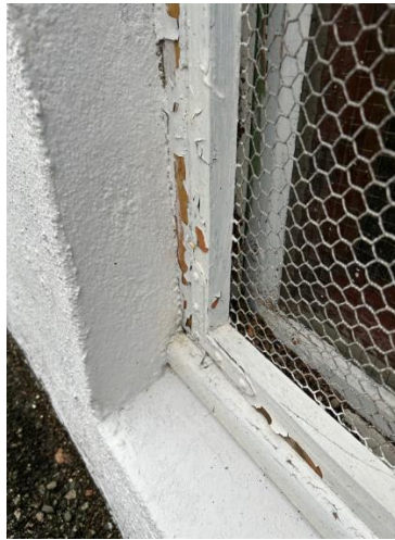
Avskallet maling rundt vindu
