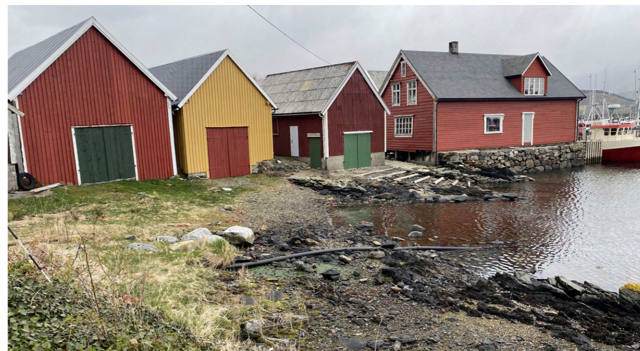
Figur 38: Den uryddede strandsonen har et rotete preg, med synlige kloakkrør.
