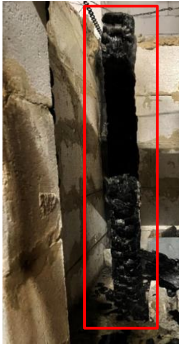
Figur 4-23: Søyle V2 (vist med rødt rektangel) etter at brannen hadde blitt slukket med vann.
