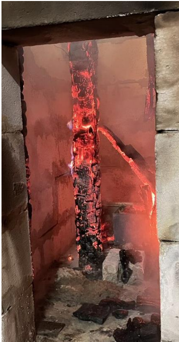
Figur 4-22: Søyle V2 før de ble brukt vann til å kjøle ned rommet og søylene.
