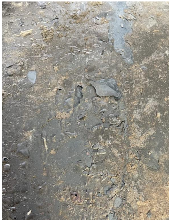
Figur 5-20: Små biter løsnet fra stålplatene.
