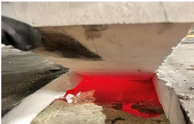
Figur 4-47: Rødglødende stålplate. Bildet er tatt ved å løfte opp takplatene (forsøk #6).
