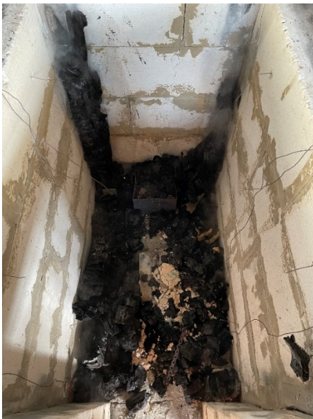
Figur 4-4: Bilde tatt ovenfra etter fjerning av tak for forsøk #11
