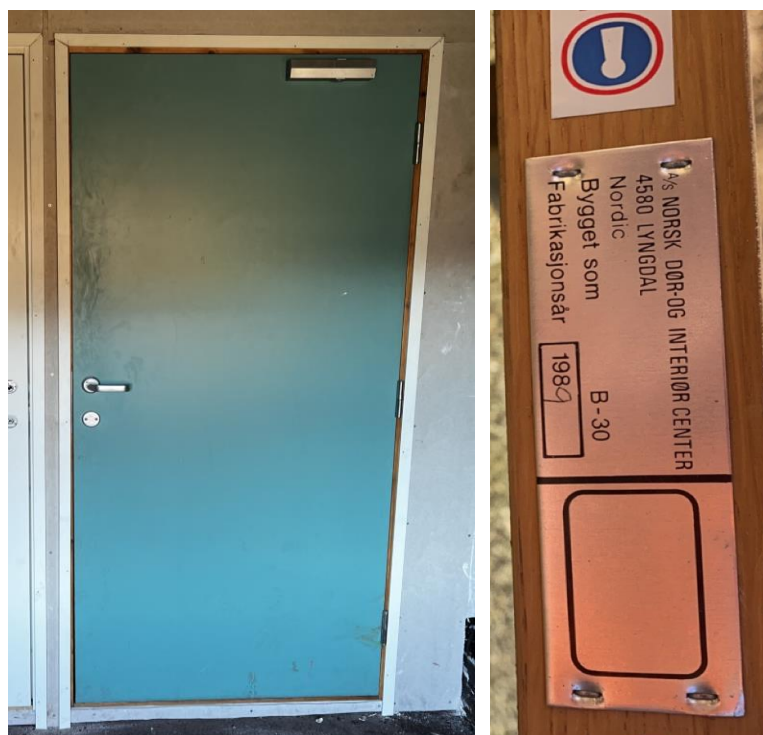
Figur 9: Viser gammel dør montert i vegg samt sertifisering.
