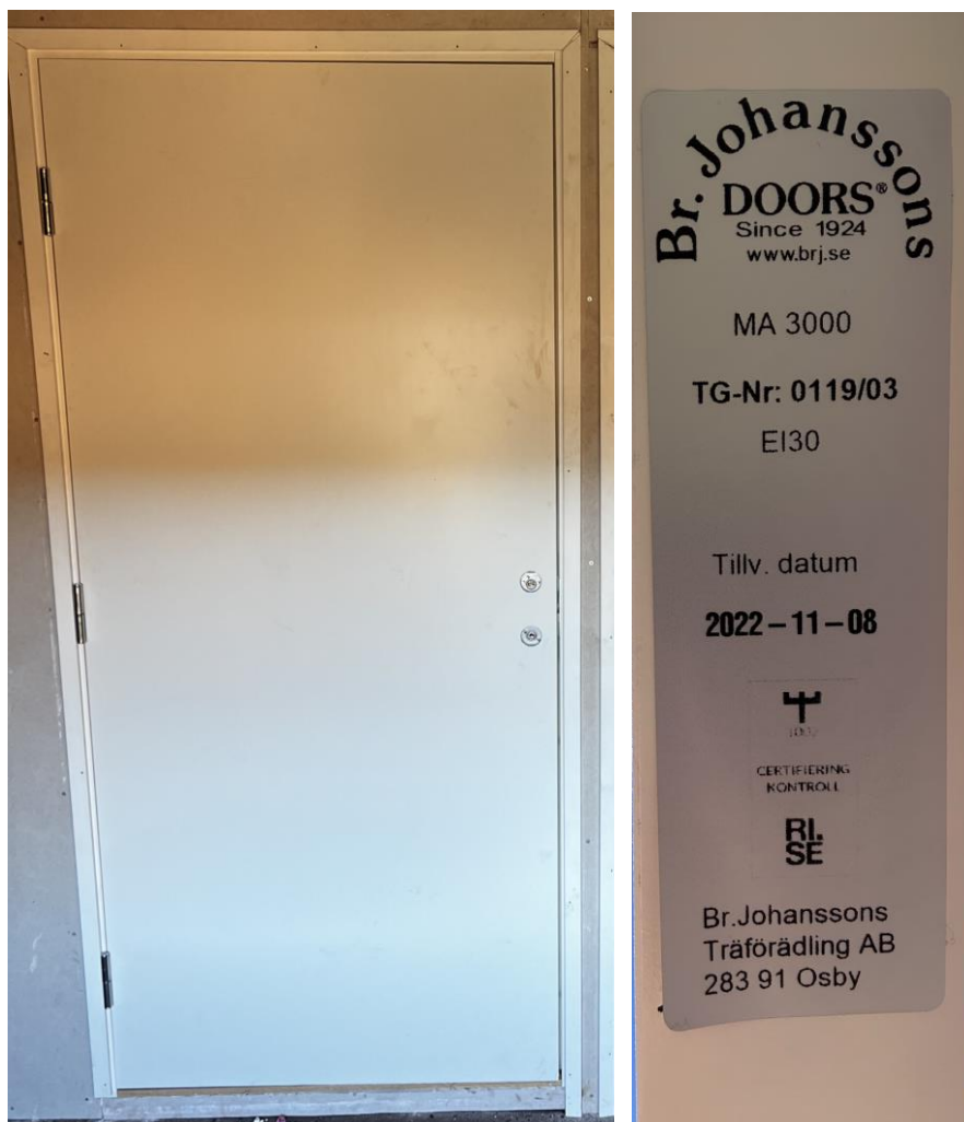
Figur 10: Viser ny dør uten dørhåndtak og låsvrider montert i vegg samt sertifisering.
