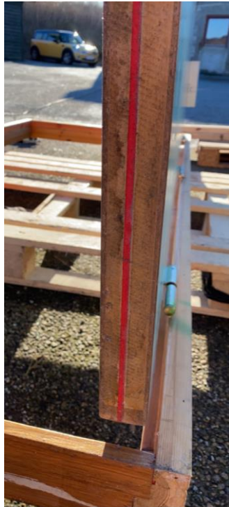
Figur 30: Viser vannskade i bunn av dørblad.
