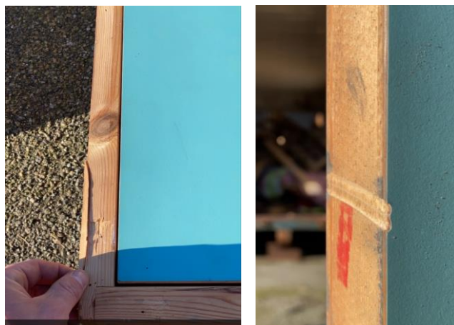
Figur 29: Viser skader på den gamle døren. Bildet til venstre viser skade i karm og bildet til høyre viser slitasjeskade på dørblad.
