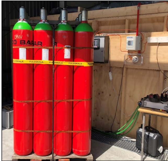
Figur 7: IG-541 flaskebanker plassert ved siden av et brannalarmanlegg og aspirasjonssystem.
