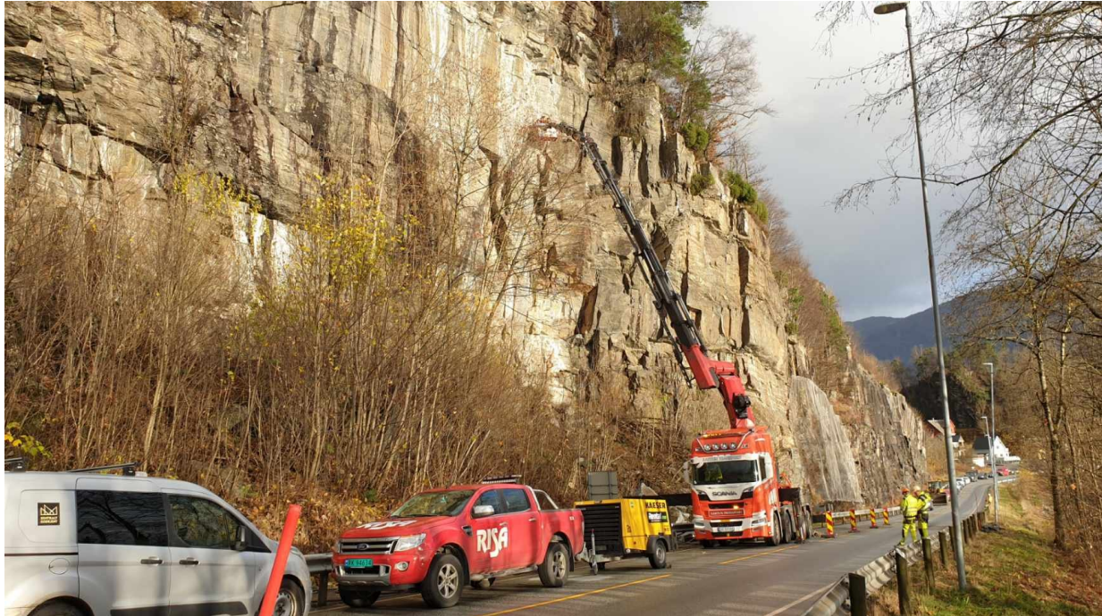
Figur 2: Illustrasjonsbilde: Inspeksjon av fjellside etter ras langs Fv520 Saudavegen, november 2021. Foto: Agnes Haker (2021).
