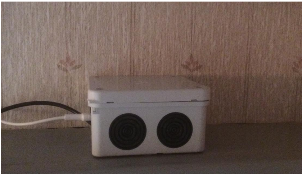
Bilde 10.3.2.1 Temperaturmåler i deksel på toppen av sikringsskapet
