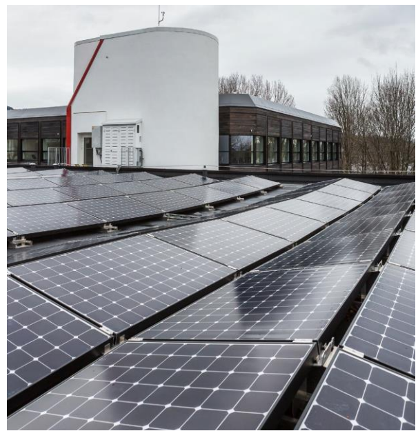
Figur 3 Solcelleanlegg Powerhouse Kjørbo (Futurebuilt, u.å.).
