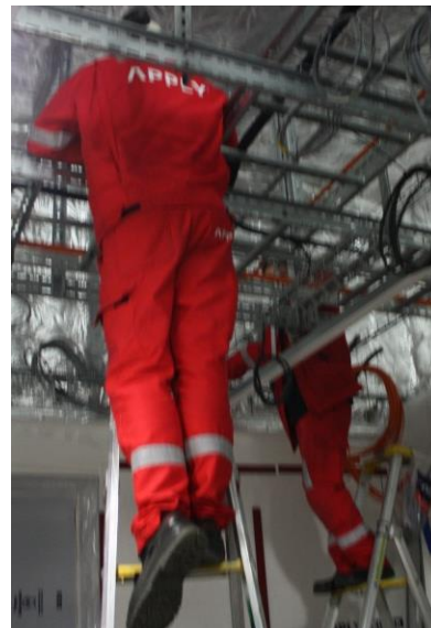
Bilde 10: Manglende fallsikring
