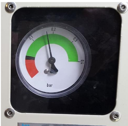
Figur 31 Trykk på SF6-anlegget
