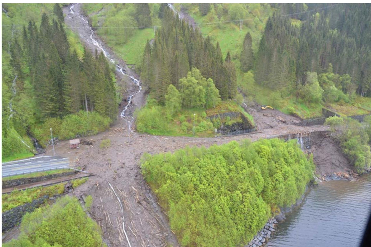
Figur 2-3: Skredhendelser ved Bogelia i Vaksdal i 2015. Skredet rammet både E16 og jernbanen. Foto: Statens vegvesen. Hentet fra silingsrapporten, s.22.
