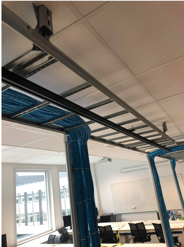
Figur 3h: Skinne hengt opp i kabelskinne.
