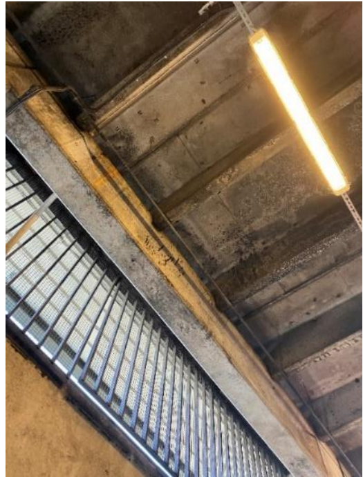
Figur 12 - Synlige brannskader på takelementer i betong
