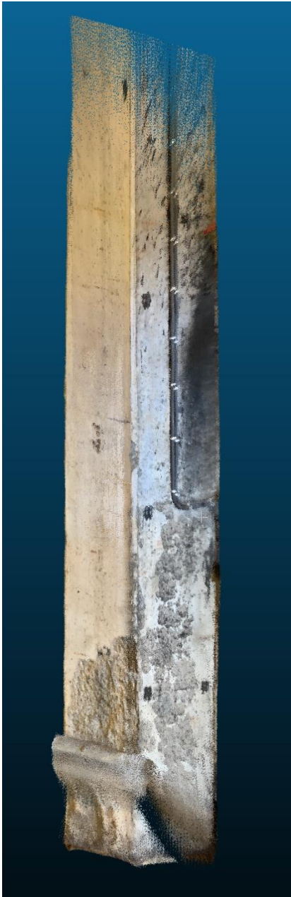
Figur 23 – Brannskadet søyle skannet med iPad Pro
