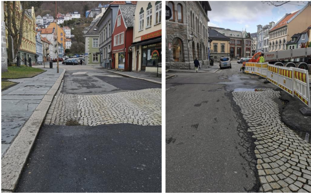
Figur 20 - Slitt dekke som bærer preg av setningsskader og oppsamling av vann, privat
