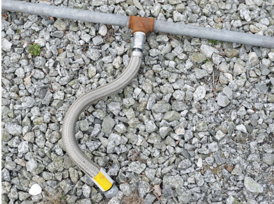
Bilde 4 - Fleksibel slange koblet opp mot fordeler røret.
