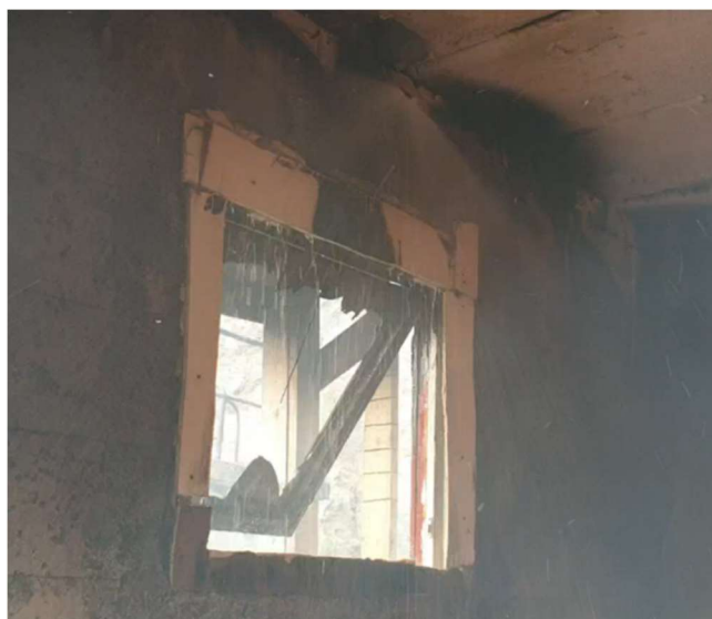
Bilde 19 - Vindu knust fra forsøk # 3, sprinklerhode aktivt
