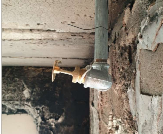
Bilde 8 - Sprinklerhodet installert med 15 graders vinkling. To termoelementer kan sees hengende over
