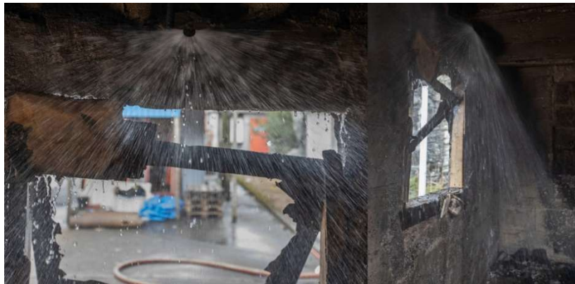
Bilde 9 - Sprinklerhodets spredemønster etter justering av vinkel
