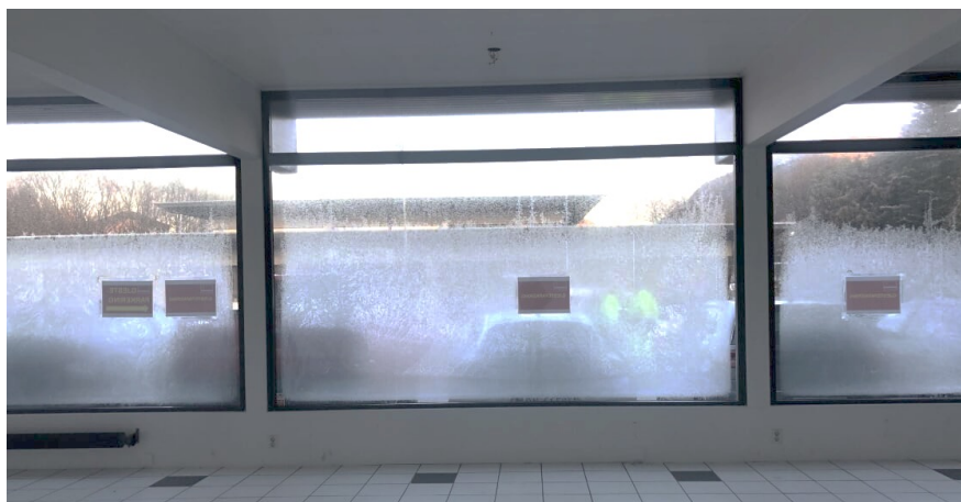
Figur 16: De store vinduene i MB-auto. Bilde ble tatt på befaring.
