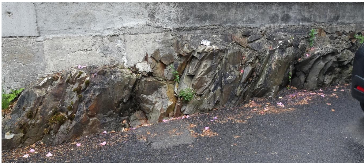
Figur 4. Noe mindre oppsprukket bergmasse ved Hunstadsvingen (lokalitet E i Figur 1).
