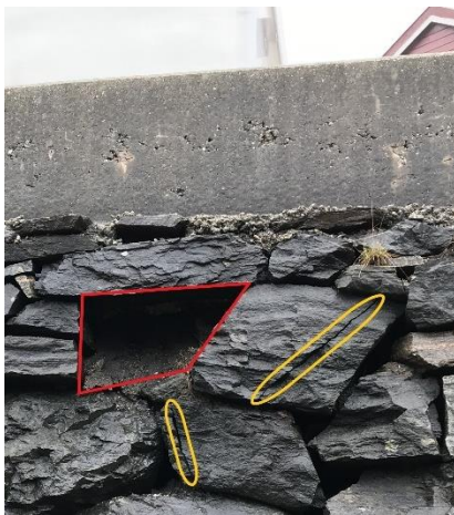
Figur 6: Sprekkdannelse og utrasing av støttemur ved Grimen Camping (Foto: Privat)
