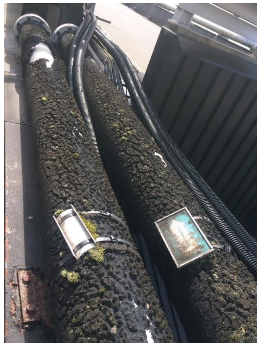
Figur 96 Slitasje i isoleringen av rør
