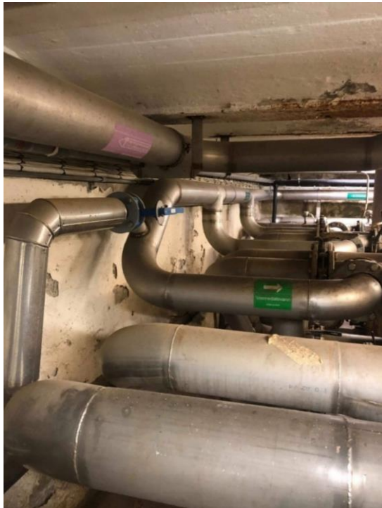
Figur 103 Rørledninger inn- og ut av varmevekslere
