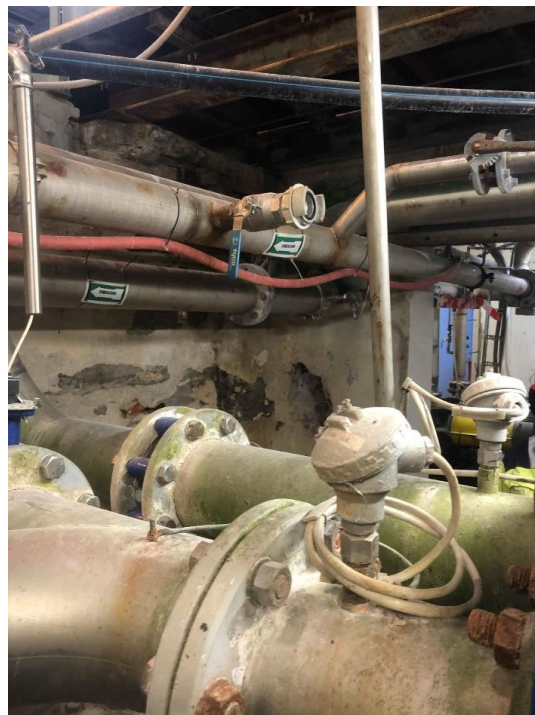
Figur 104 Volumstrømsmåler til varmeveksler
