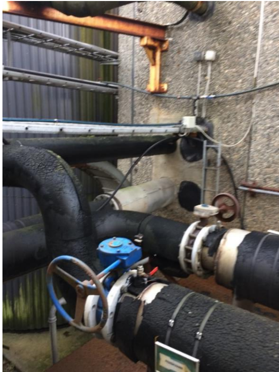
Figur 101 Rørledning ved buffertank
