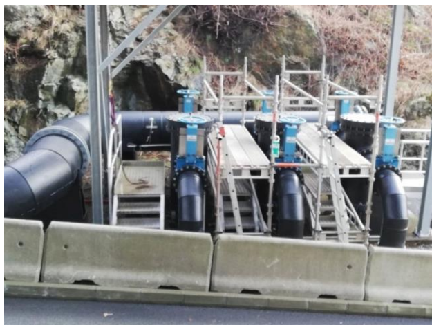
Figur 107 Silsystem utenfor fabrikkområdet
