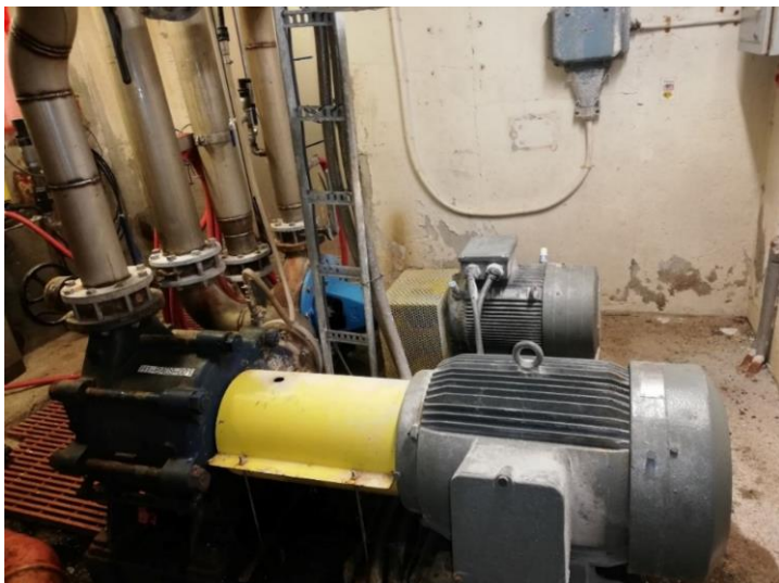
Figur 105 Pumpe i H1 mot varmevekslere og forbruk
