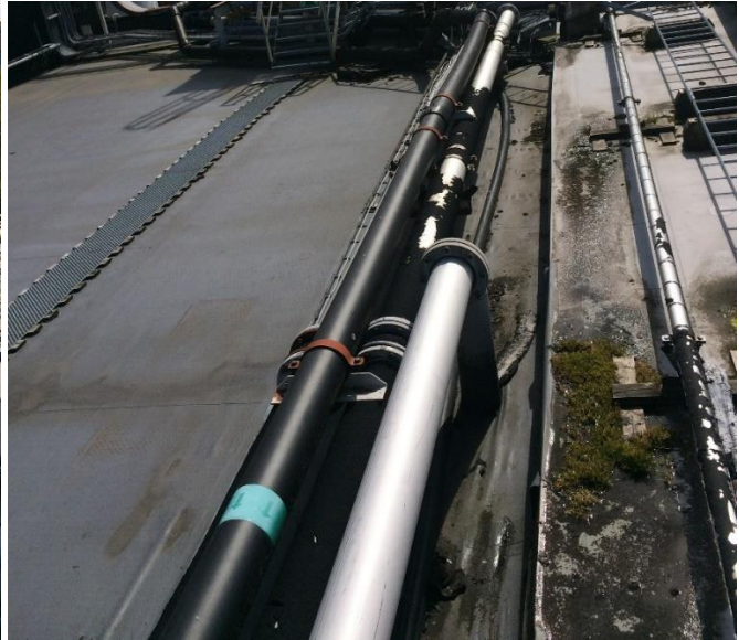
Figur 93 Bilde av rørledning for H1 og H2 over tak og ned mot buffertank
