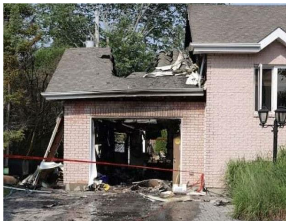
Figur 2-9 Eksplosjon fra brann i elektrisk kjøretøy Kilde : Hentet fra [18]
