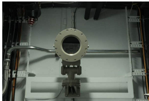
Overvåkingskamera i batterirom
