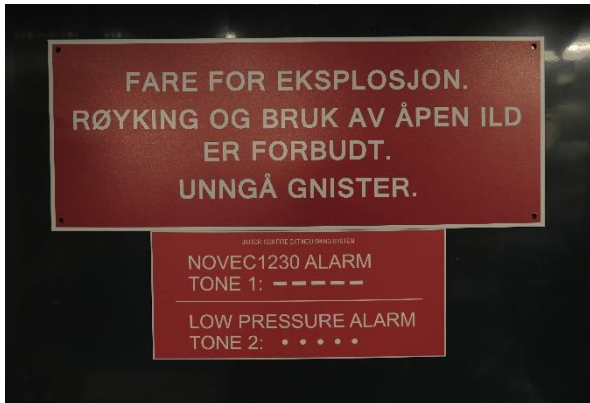
Fareskilt på dør inn til batterirom
