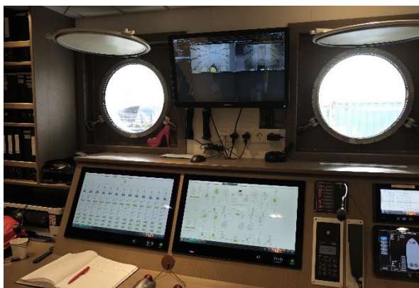
Kontrollrom som overvåker batteriene
