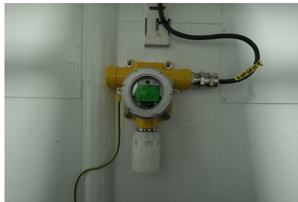
Gassmåler i batterirom
