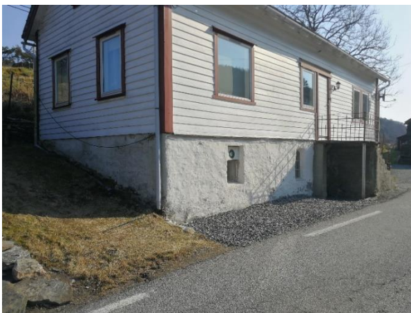
Figur 9. Bebyggelse ved profil nr. 550, der avstanden er 1,2 m fra husvegg til veikant
