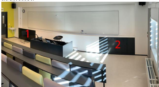
Figur 21: Auditoriet med tilluftsdon markert
