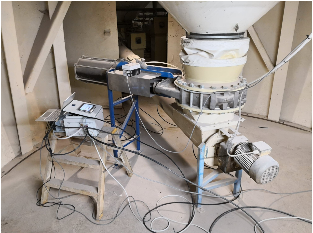
Figur 12. Testtrigg tilkoblet anlegg på Biomar
