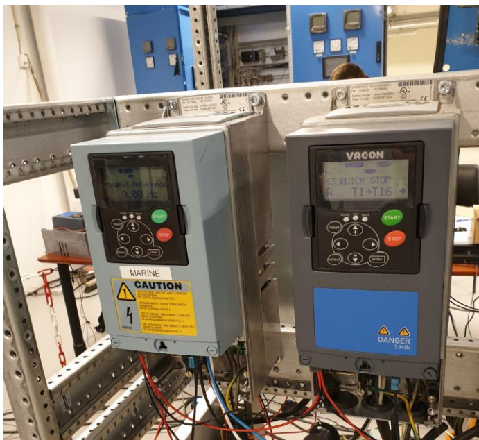
Figur 23: Luftkjølt Vacon-NXP frekvensomformere
