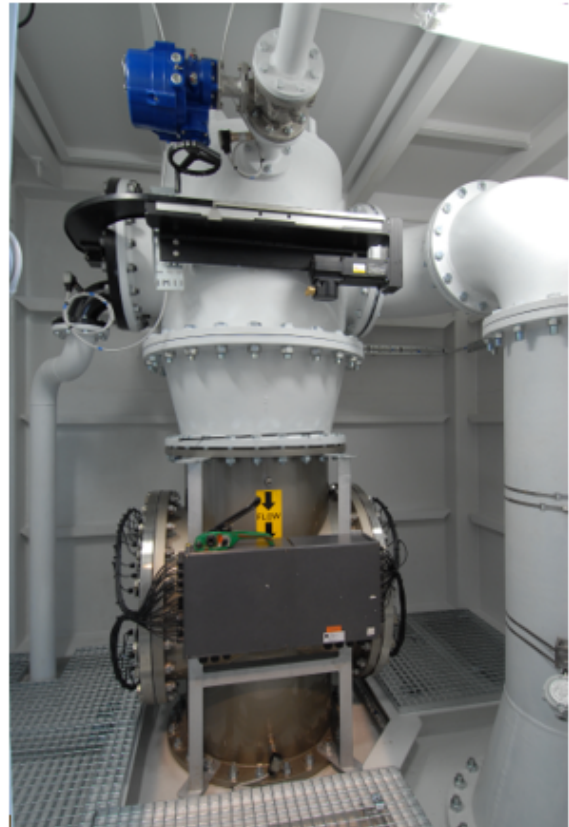
Figur 15 Hvordan renseanlegget KBAL ser ut på et skip
