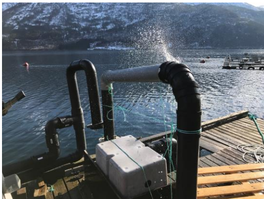
Figur 6: Pumpen som pumper opp vann fra 100 meters dyp.
