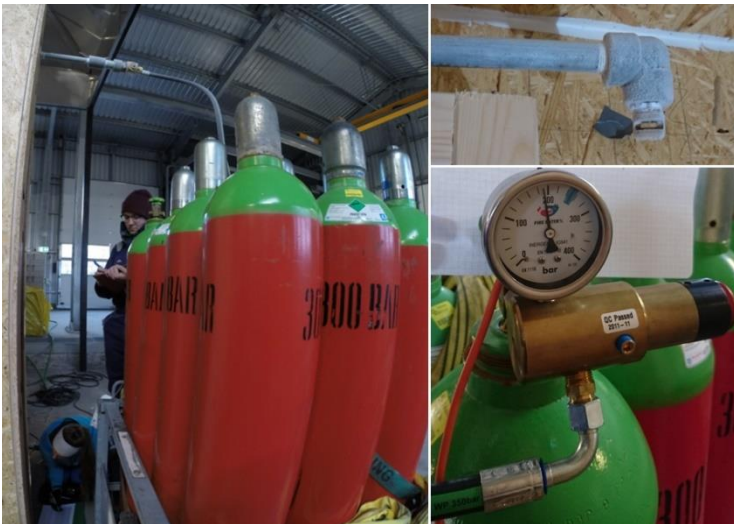
Bilde 10 Oversikt over INERGEN-anlegget
