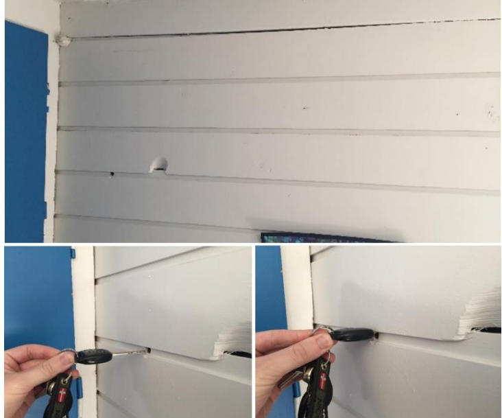
Bilde av lekkasjeåpninger inn til hulrom i veggkonstruksjon.
