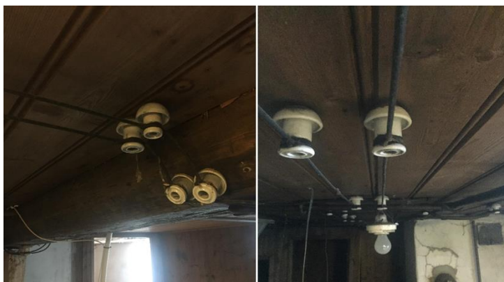
Bilder av utdatert elektrisk anlegg.
