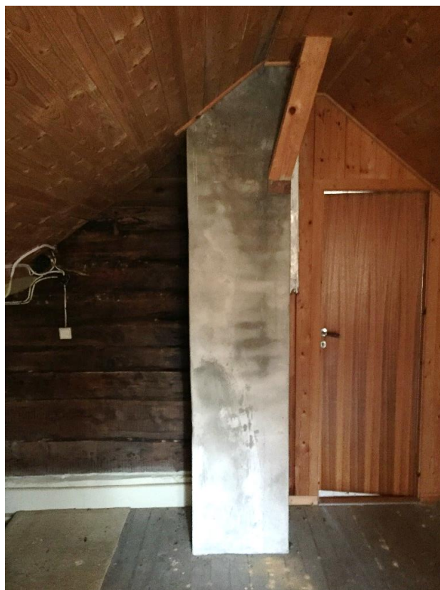
Bilde av dårlig brannteknisk løsning av pipe.
