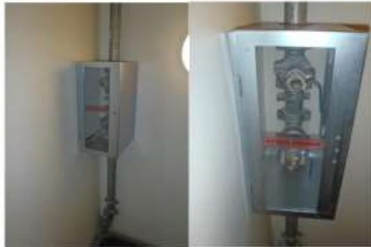
Figur 6 Godt eksempel på skal for beskyttelse av stigeledning/tørropplegg mot hærverk.
