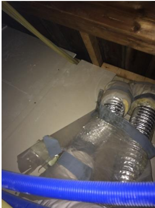
Bilde 2: Tatt opp i luke i himling i rømningskorridor og viser manglende ivaretagelse av brannkrav på tak, utett tilslutning, utette gjennomføringer, ikke godkjente ventilasjonkanaler mm.
