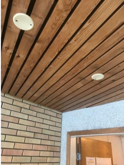
Bilde 7: Bruk av trespilehimling i Rømningsvei i strid med prosjektert løsning
