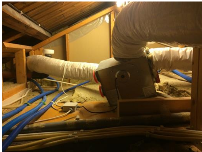
Bilde 3: I leilighet er det i en del av leiligheten bygget himling. Bildet er tatt over himlingen der det ses el-føringer, koblingsbokser, og ventilasjonsaggregat. Selv om himlingen skulle vært klassifisert vil ikke dette hindre en brann i å raskt spre seg til hulrommet, enten ved at brannen starter i rommet under og spres via uklassifiserte vent-kanaler eller at det starter i selve vent-aggregatet eller i el-koblingsbokser etc.
