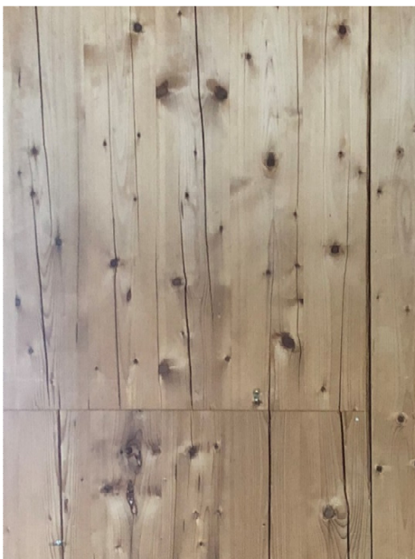
Figur 6: Svartlamoen: Sprekker i veggelement
