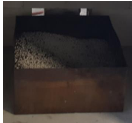
Figur 27 Gassbrenner i brennkammer
