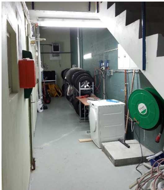
Bilde 1: Ukritisk bruk av branncelle som har annen funksjon enn lagring.
