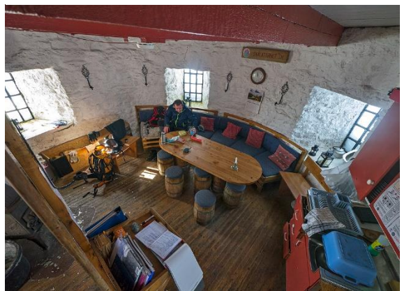
Figur 6.12. Skålatårnet innvendig. Bredden på muren kan tydelig sees ved vinduskarmene. (Kjartan Haugen, 2012).
