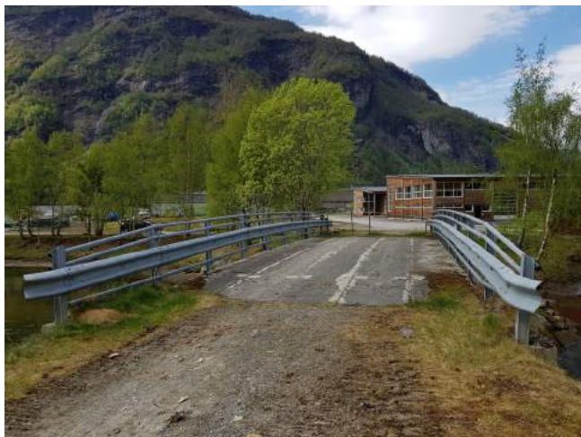
22-Bro. Broa over Engjadalselva er et viktig og synlig element som binder sammen de to sidene av området. Broa fremstår som slitt og massiv.
