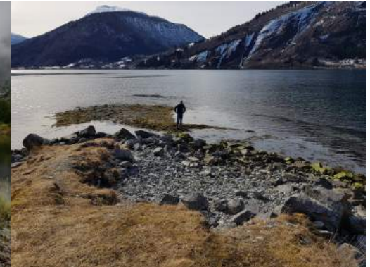
Figur 32 - Fotoet viser at tuppen av moloen er tydelig preget av utglidning av masse.
