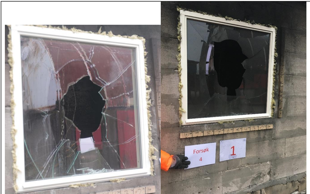
Mekanisk knust vindu før (venstre) og etter (høyre) brannpåvirkning.
