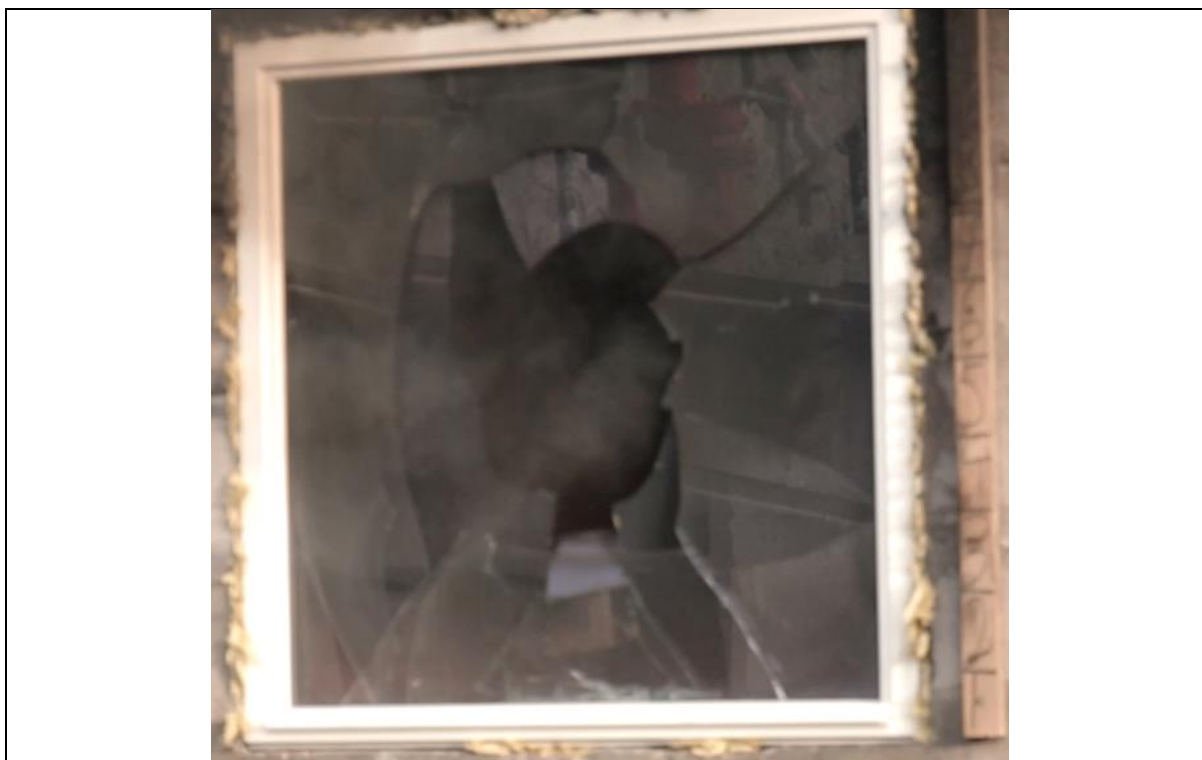
Vindu 1 underveis i forsøket. Deler av glasset har knust, men man kan fortsatt kjenne igjen bruddmønsteret til det mekaniske bruddet.
