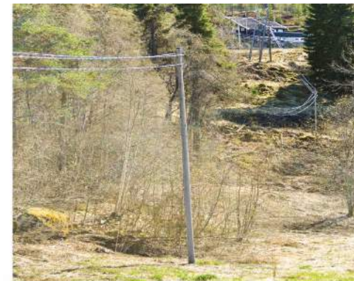
Strømledninger opp til høyspent linje
