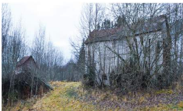
Nærbilde av låve og uthus i dårlig forfatning
