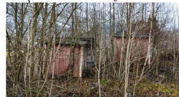
Uthus i dårlig forfatning
