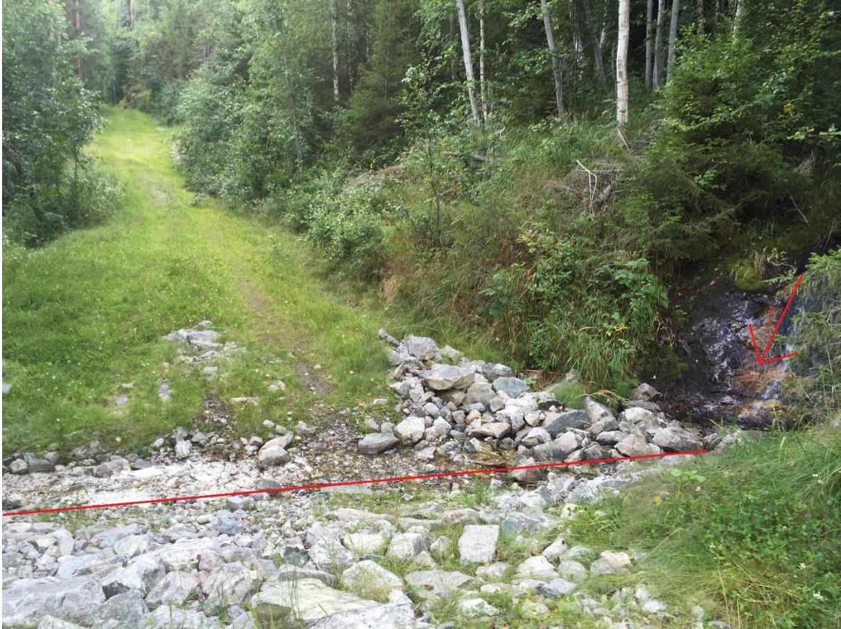
Figur 6.1 Den røde pilen viser der bekken renner ned til skogsbilveien. Den røde streken viser der bekken renner over veien i en åpen stikkrenne, istedenfor en stikkrenne under veien. Bildet er tatt retning sør. Foto: Renate R. Johansen
