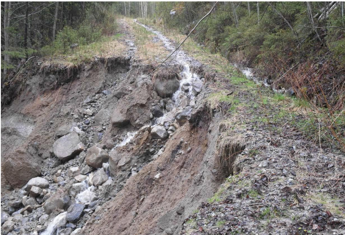
Figur 5.42 viser utløsningsområdet til en av skredbanen som startet i skogsbilveien den 23.05.2013. Foto: Ulrik Domaas, NGI
