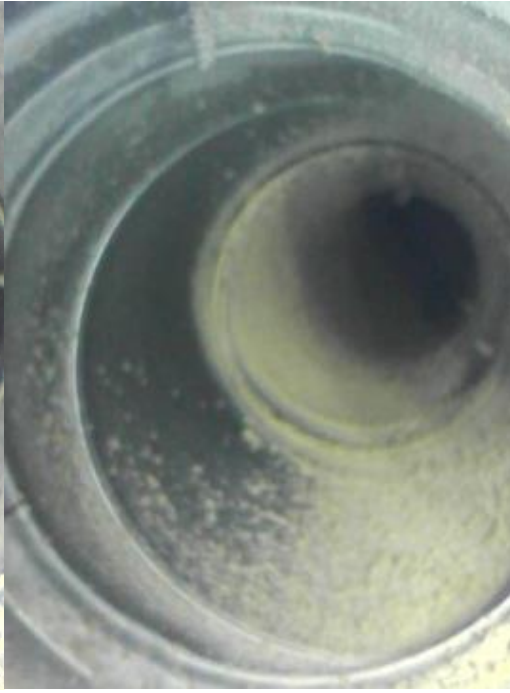
Figur 6b. Avtrekkskanal i leilighet nr 6.
