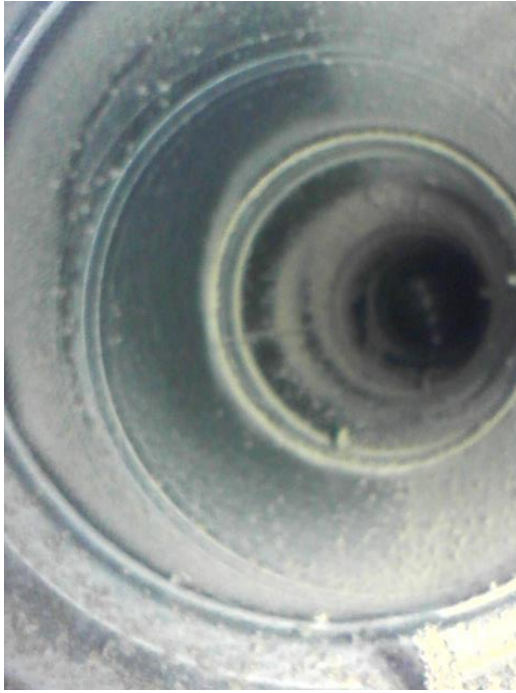
Figur 6a. Avtrekkskanal i leilighet nr 5.
