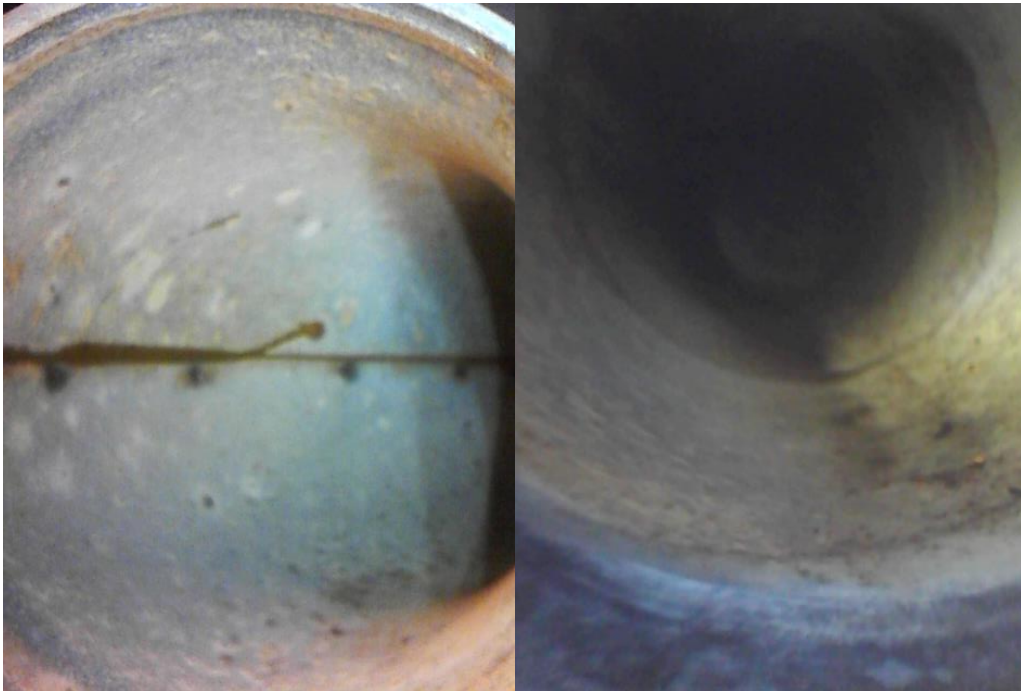
Figur 5a. Avtrekkskanal i leilighet nr 3.
