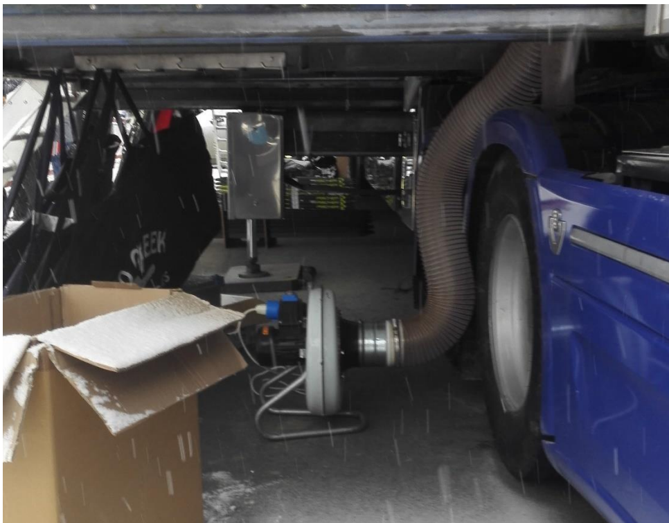
Figur 6: Vifte som driver det spesialkonstruerte avtrekket i smøreprofilen i pulverrommet.
