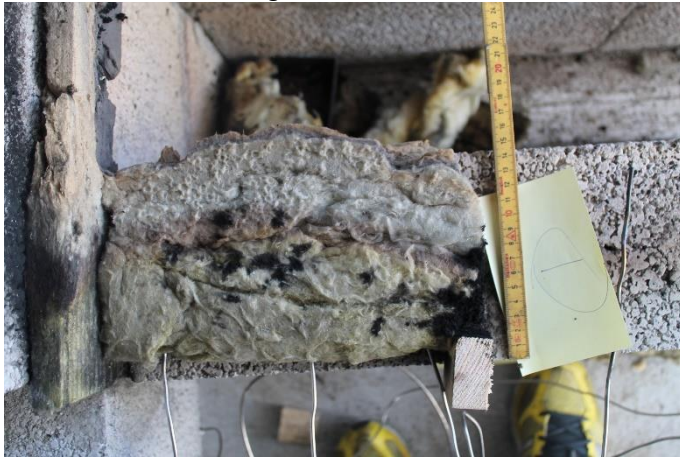
Bilde 11: Fuge 1 fra forsøk 6, fuge 5 datt ned, men kan ses i bakgrunnen
