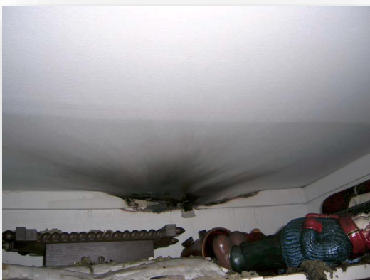
Bilde 2: "Utilfredsstillende tetting mellom vegg og himling mellom korridor og tidligere hobbyrom", DSB
