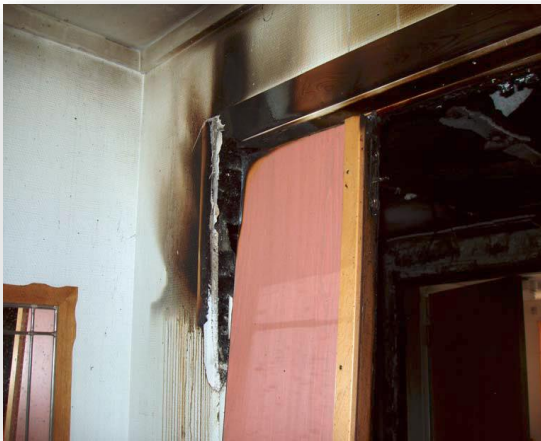
Bilde 1: «Gjennombranding mellom karm og vegg ved dør til tidligere hobbyrom», DSB
