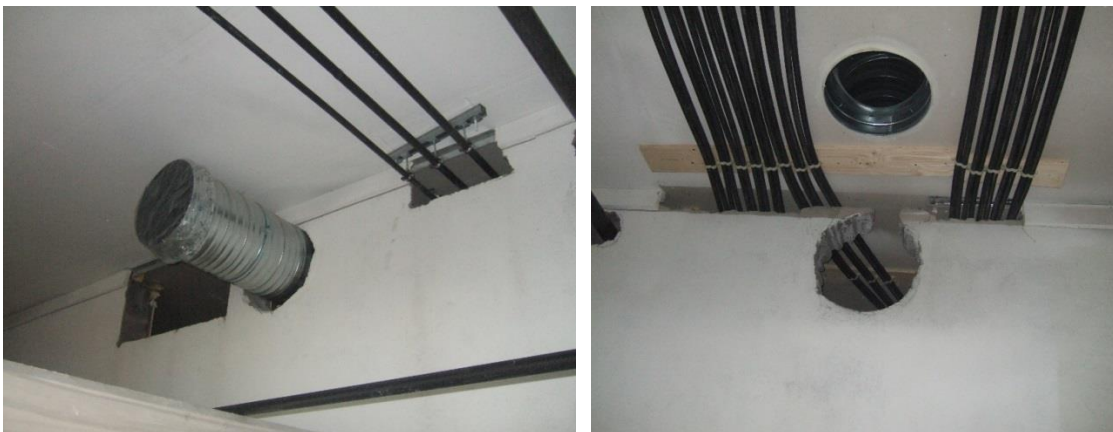
FIGUR 32: EKSEMPEL PÅ FOR STORE UTSPARINGER TIL RØR OG KANALER
