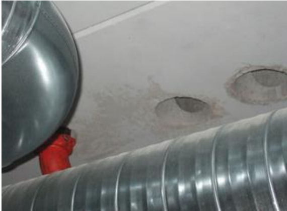
FIGUR 31: EKSEMPEL PÅ UTILGJENGELIGE UTSPARINGER I TEKNISK ROM
