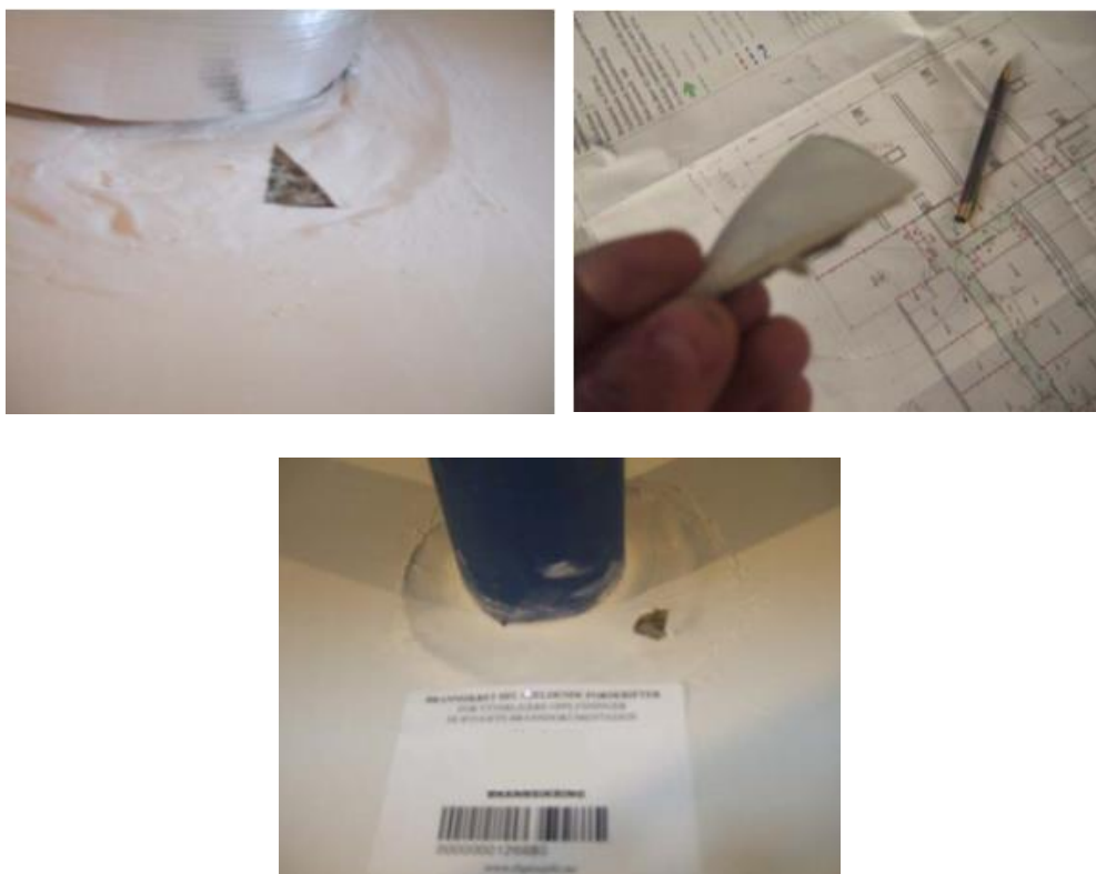
FIGUR 28: EKSEMPEL PÅ FOR TYNT LAG MED TETTEMASSE
