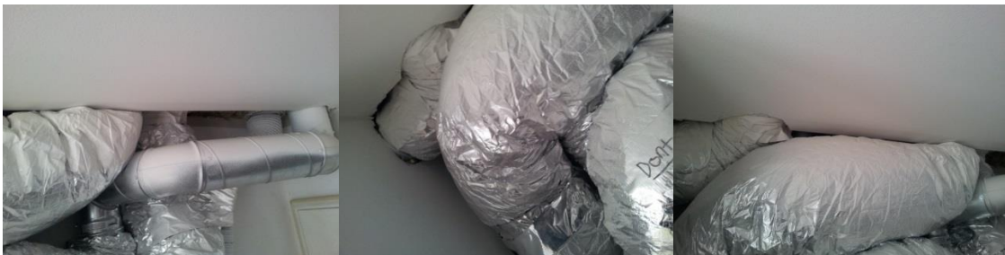
FIGUR 37: EKSEMPEL PÅ UTILGJENGELIGE GJENNOMFØRINGER
