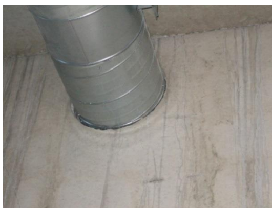
FIGUR 16: EKSEMPEL PÅ UTFØRELSE FRA DET ENE EKSEMPELBYGGET HVOR UTSPARING IKKE GIR ROM FOR Å KUNNE UTFØRE BRANNTETTING PÅ TILFREDSSTILLENDEN MÅTE
