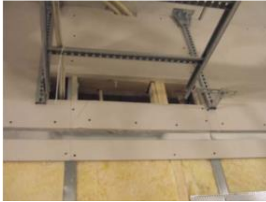
FIGUR 18: EKSEMPEL FRA EKSEMPELBYGGENE HVOR DET ER FØRT INSTALLASJONER HORISONTALT OG VERTIKALT GJENNOM UTSPARINGER HVOR HVERKEN VEGG ELLER TETTEMASSE ER TESTET FOR DETTE.
