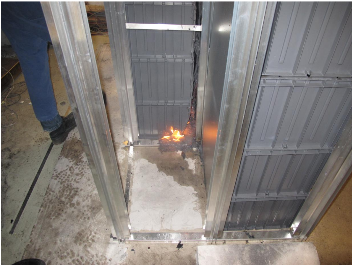
Figur 12-16 Pølbrann på kald side etter at slokking på varm side var utført
