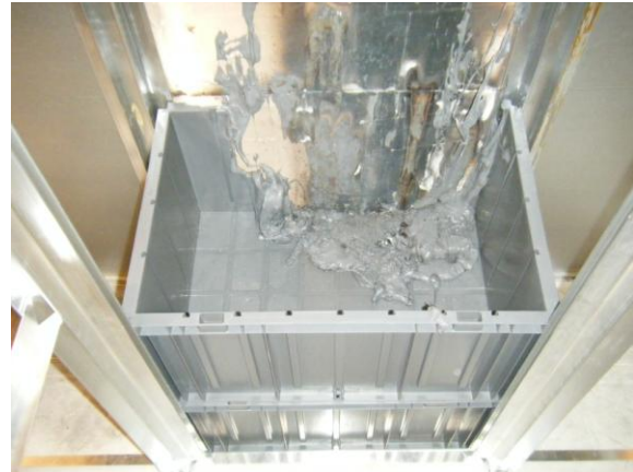
B: Kasser plassert i grid, nr to fra gulv
