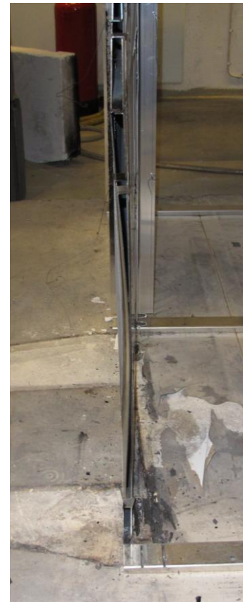
B: Stålplatene har slått inn mot hverandre
