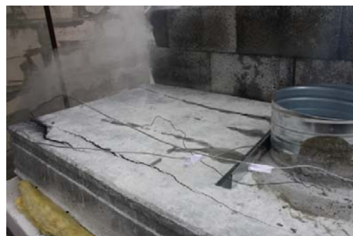
Figur 42, Fukt observert i sprekker fra oversiden
