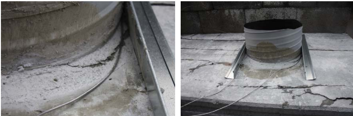
Figur 22, Sprekkdannelse ved ventilasjonsrør, test 1
