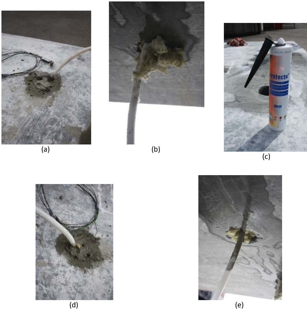
Figur 14, K-rør, (a) m/brannfugemasse sett ovenfra (b) m/brannfugemasse sett fra undersiden (c) Protecta brannfugemasse (d) u/brannfugemasse sett ovenfra (e) u/brannfugemasse sett fra undersiden
