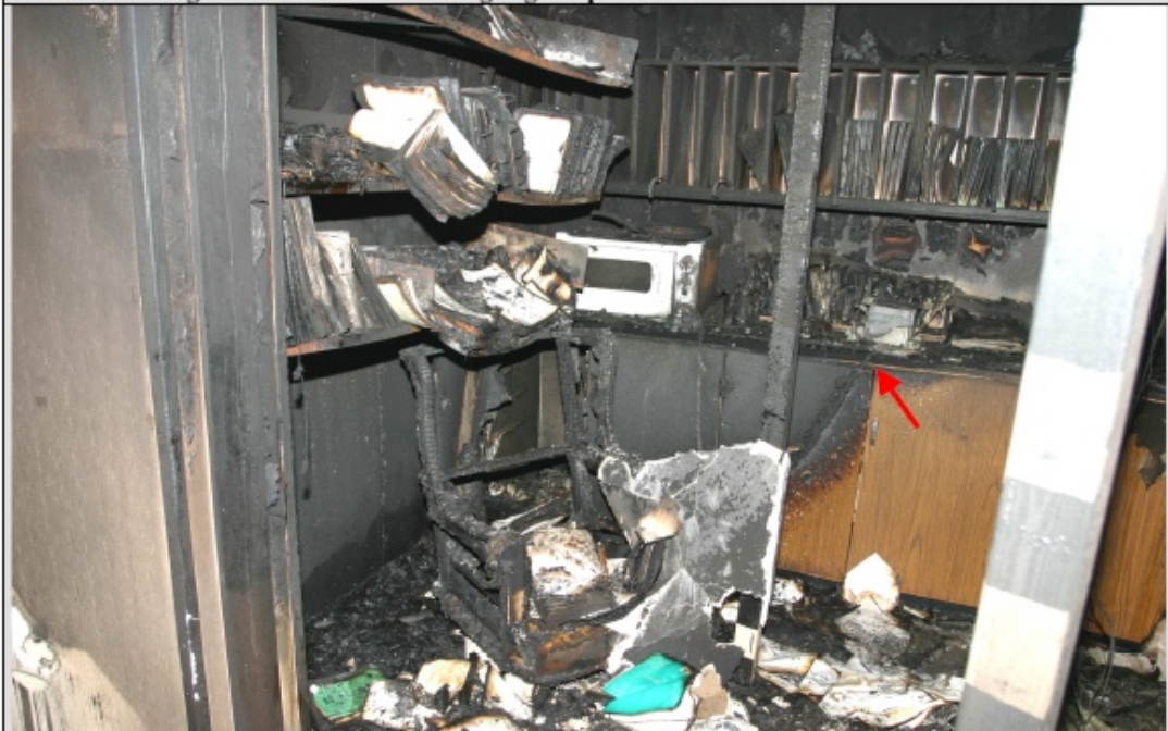
Fig. 4 Hjørnet i rommet som vist på fig. 3. Pil viser mot punkt på kabel til brødrister hvor det ble påvist kortslutningsspor.
