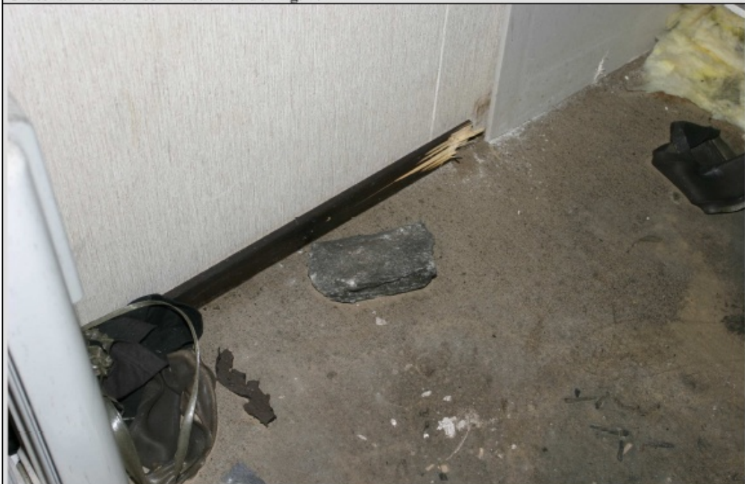
Fig. 8 Stein sikret fra gulvet i gangen utenfor døra til pauserommet.
