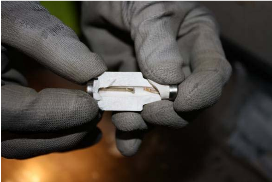
Avbrenning vitner om høy energi og kortslutning
