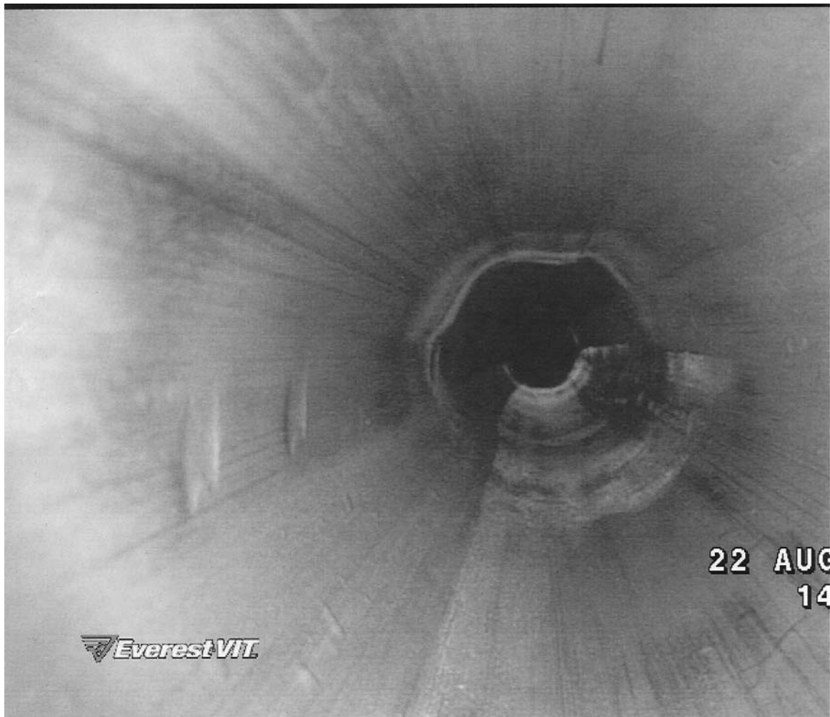
Bilde 4-2.2 Mulig korrosjon i rørsats HA-310 (2004)
