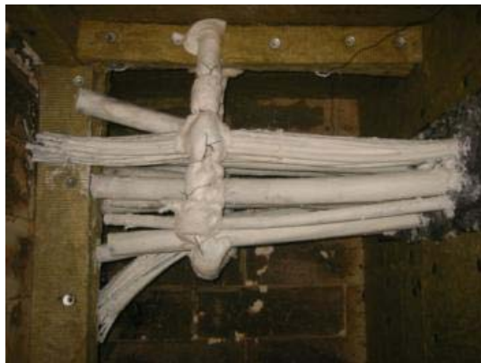
Bilde 1.1 – Kabelgjennomføring med brannhemmende kabelmaling
