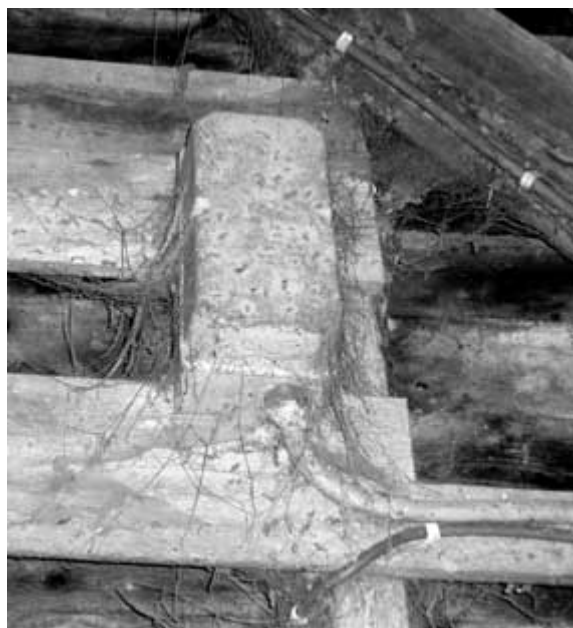
Vedleggsfigur 8 Hovedstrøminntak på vegg over sikringsskap. (Foto: I-J Helland)
