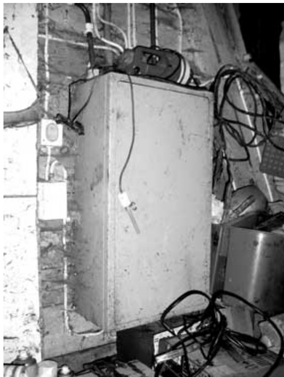
Vedleggsfigur 7 Sikringsskapet på låven. (Foto: I-J Helland)
