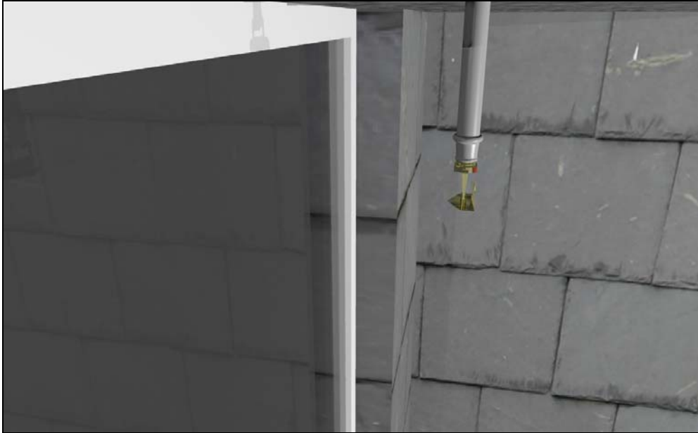
Figur 18: Sprinklerhode sett fra siden
